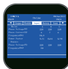
Контрольная панель шкафа ИБП
