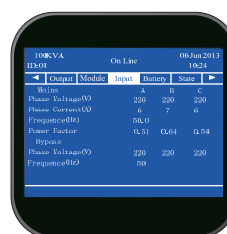
Контрольная панель шкафа ИБП
