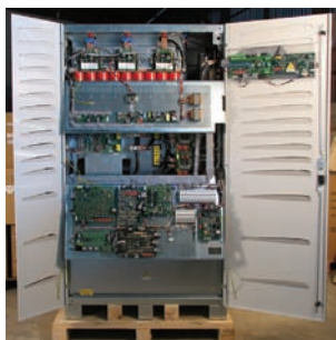
N-Power Evo 200 кВА внутреннее устройство
