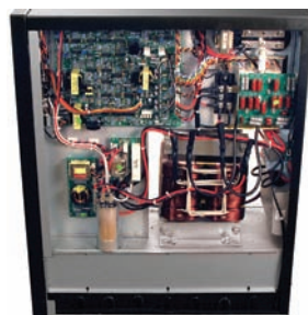
Изолирующий трансформатор, аккумуляторные батареи снизу в лотке
