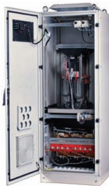
Стабилизатор Oberon M - IP54 (25-160 кВА) внутренняя компоновка
